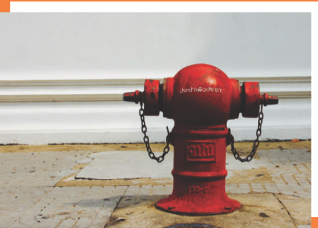
消火システム 投与ヘッド 150 m. 圧力 100 psi をプロジェクト全体に分配。
