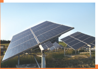
太陽系 フローティング (Floating System) と屋根式 (Solar Rooftop) が設置。
