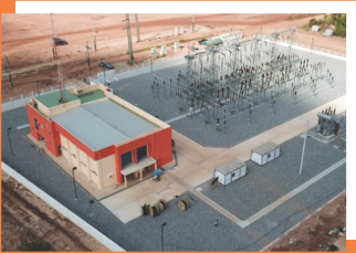
電気系統 プロジェクト内には、サイズ 115 KV の地方電力公社の変電所があります。
